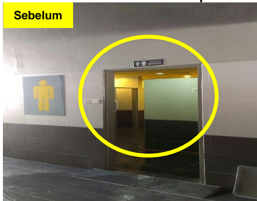
Gambar 4.11 Jeriji Aluminium Tidak Dipasang Pada Pintu Utama Tandas Perempuan
