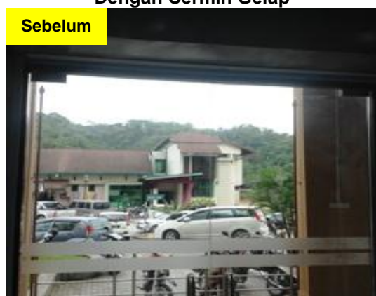
Gambar 4.13 Pintu Masuk Utama Tidak Dipasang Dengan Cermin Gelap
