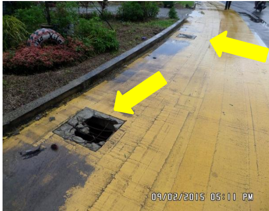
Gambar 4.21 Keadaan Lorong Basikal Berlubang Yang Tidak Dibaiki
