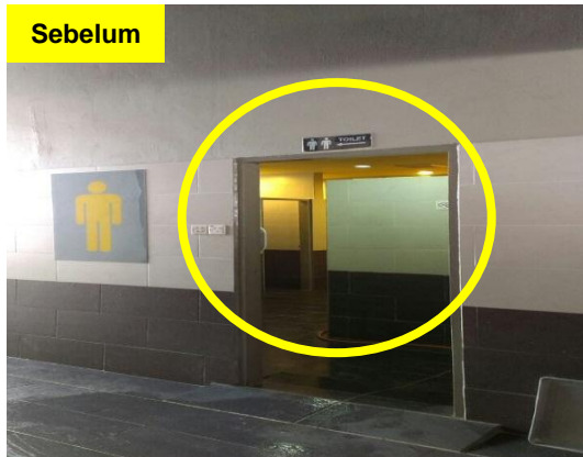
Gambar 4.9 Jeriji Aluminium Tidak Dipasang Pada Pintu Utama Tandas Lelaki
