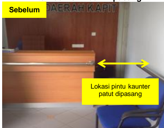
Gambar 4.17 Pintu Kaunter Tidak Dipasang
