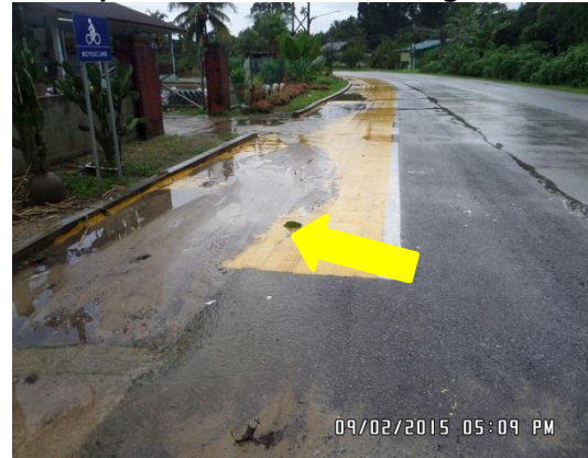
Gambar 4.22 Keadaan Takungan Air Dan Mendapan Lumpur Di Permukaan Lorong Basikal
