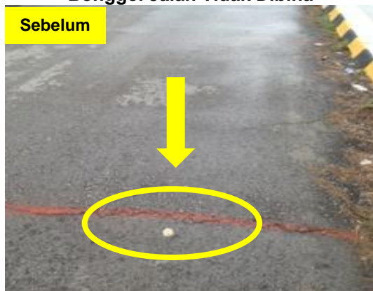
Gambar 4.5 Bonggol Jalan Tidak Dibina
