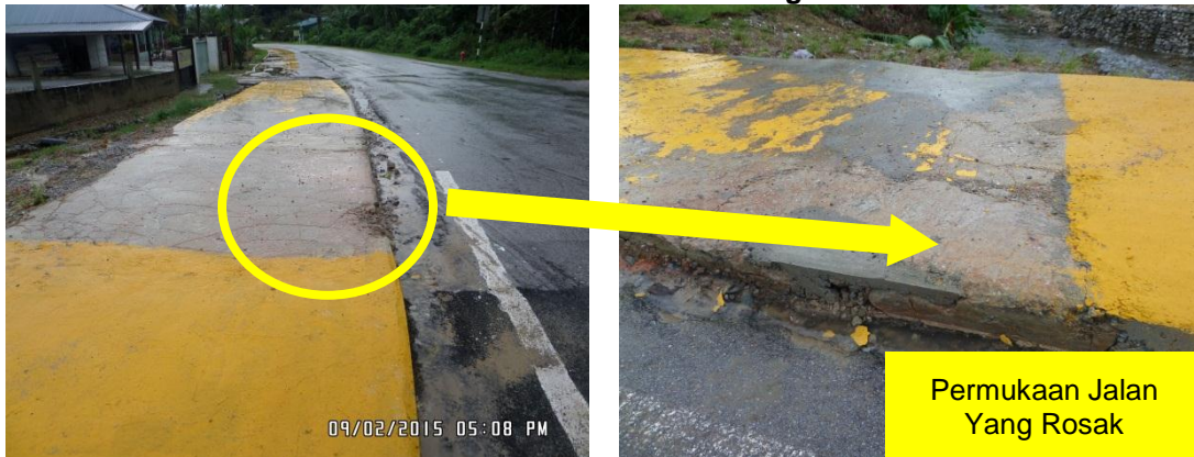
Gambar 4.23 Kerosakan Pada Permukaan Lorong Basikal
